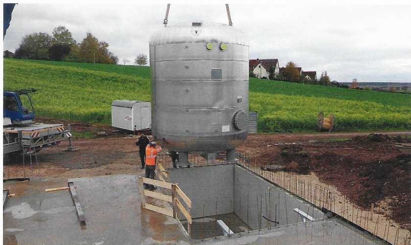
Anlieferung der Pufferspeicher (oben), Rohrleitungen (Mitte) und Großpufferspeicher an der Heizzentrale (unten)
